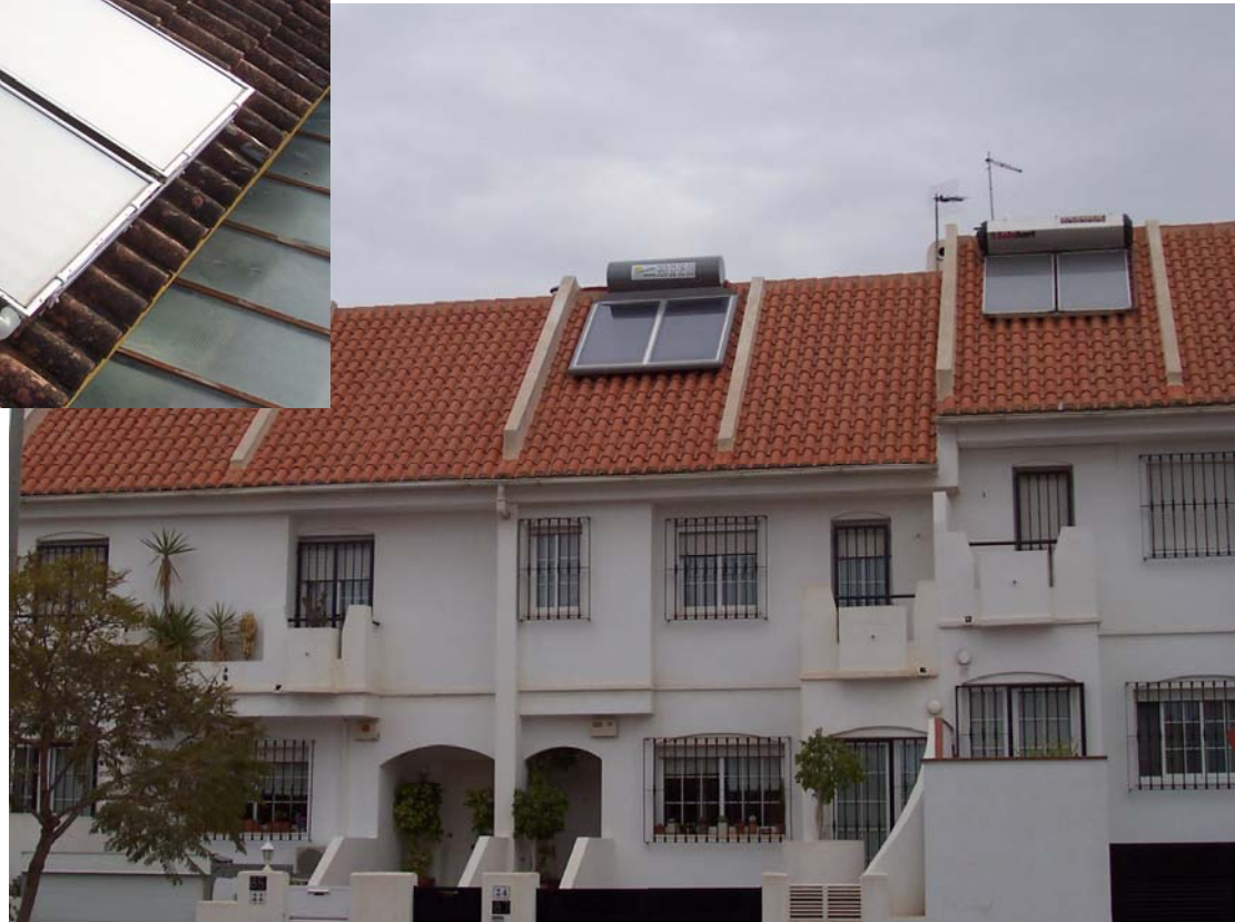
Instalaciones Solares Térmicas de baja temperatura (P. Simplificado)
