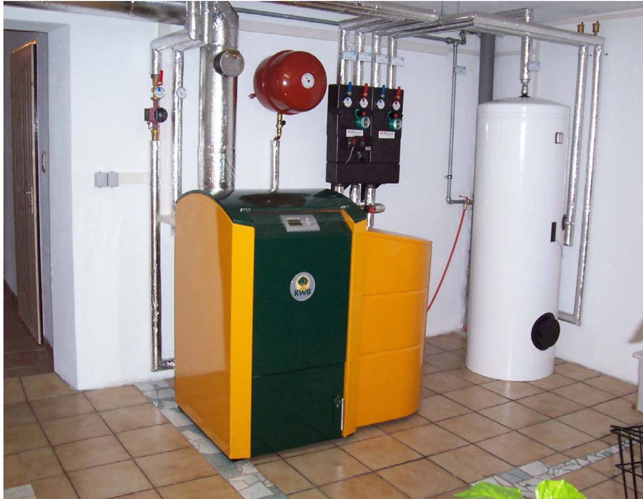
Caldera de biomasa de 20 kW en vivienda (P. General)
